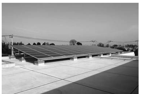
新しい小川町一丁目地域センター・児童館に設置された太陽光発電機器
