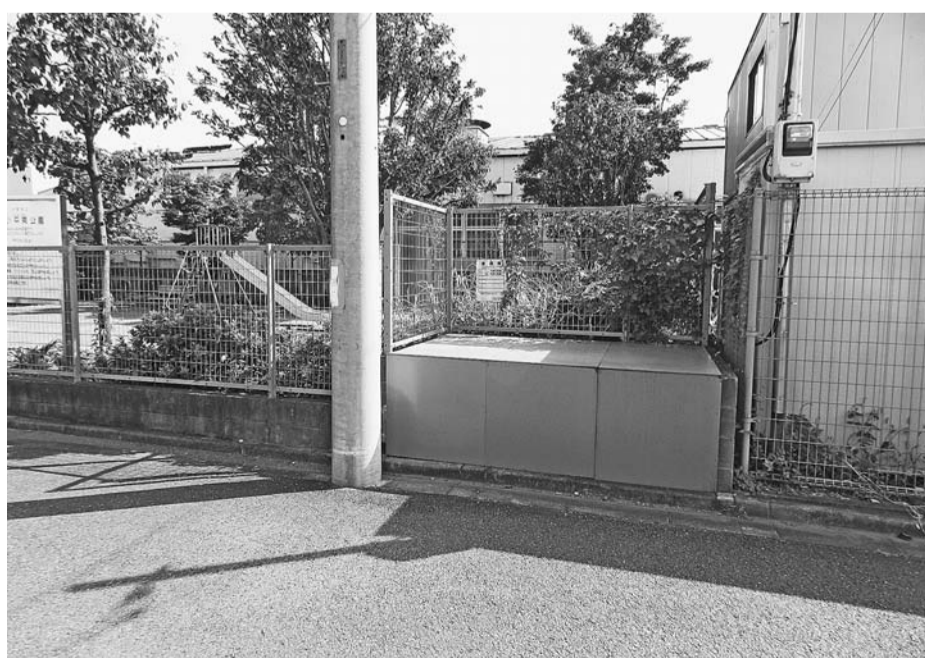
コンクリートパネルで塞ぐ処置がされたごみ集積所跡地(新小平東公園)
