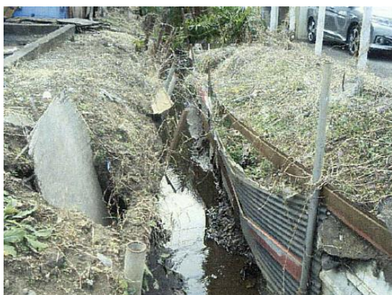
護岸の劣化状況
