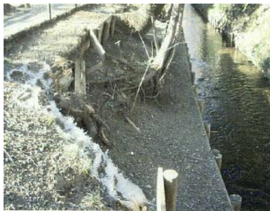
法面の浸食状況
