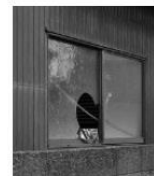
窓が割れた 管理不全空家
