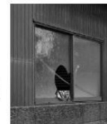
窓が割れた 管理不全空家
