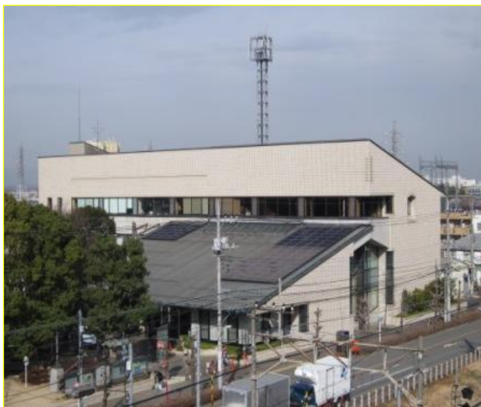
小平市中央図書館の太陽光発電設備(平成24年度設置)
