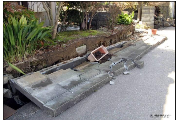
ブロック塀倒壊事例（出典：（財）消防科学総合センター）
