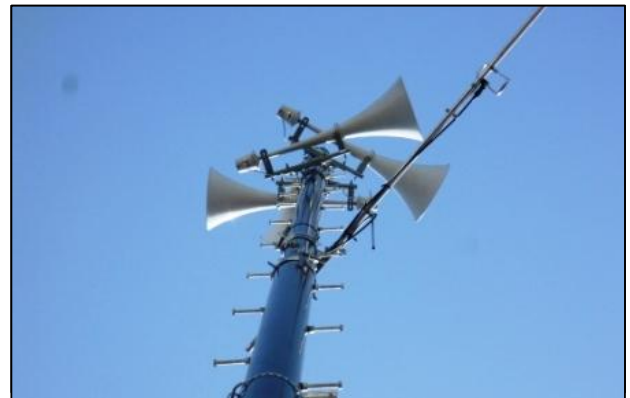
デジタル化改修する防災行政無線
