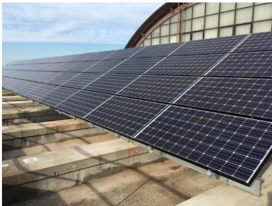
太陽光発電設備(市民総合体育館)
