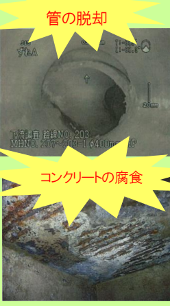
出典：国土交通省ホームページ 図：下水道施設に起因した道路陥没状況
