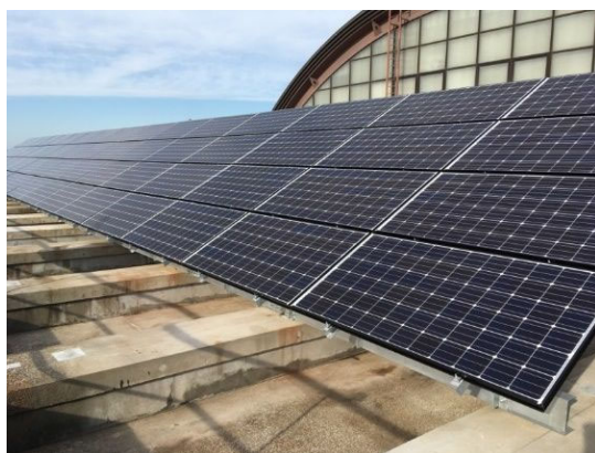
太陽光発電設備(市民総合体育館)
